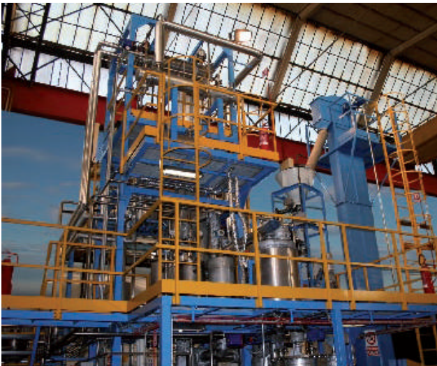
Fig. 5.26 – Impianto sperimentale Vuzeta, Brescia
