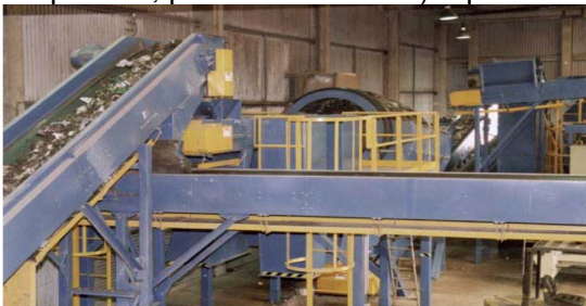
Fig. 30 - Pretrattamento del rifiuto a Inverboyndie [1].
