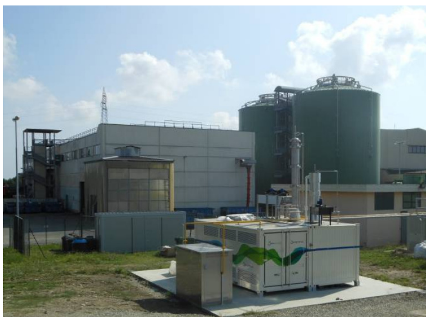
Fig. 5.4 – L'impianto di digestione anaerobica di ACEA, Pinerolo.
